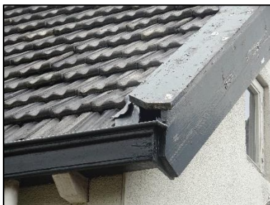
Figuur 9. Zicht op ruimte tussen de gevelbetimmering en loodslabben.
